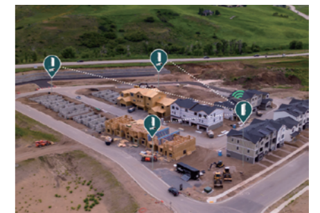
建設現場 離れた場所からリアルタイムで進捗状況の確認や物流管理ができます。
