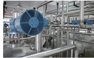
産業用オートメーション 制御システム
